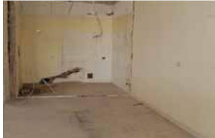
Das war die Küche, die auch schon in die Jahre gekommen ist.
